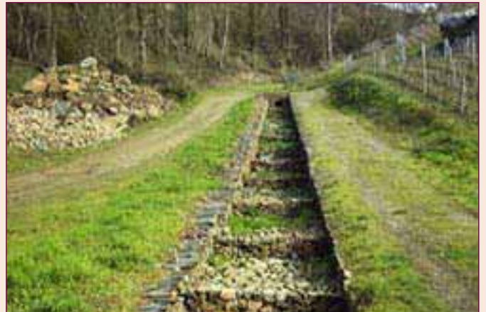
Conduite des eaux en limite de parcelle AOC Coteau du Layon.
